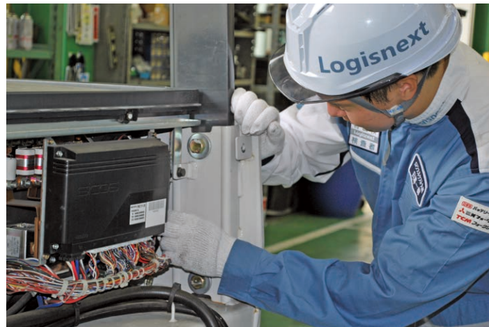
物流機器の点検
